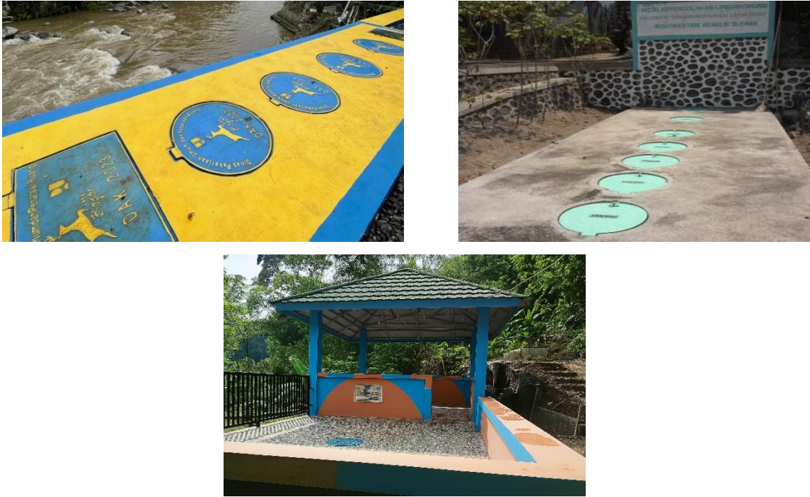
Gambar 2. 24 Sarana Pengolahan IPAL Komunal
