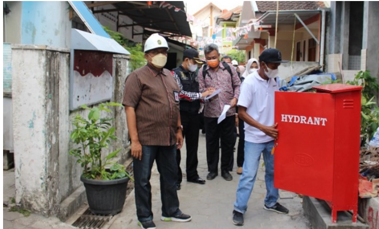
Hidran Kering untuk Permukiman Padat
