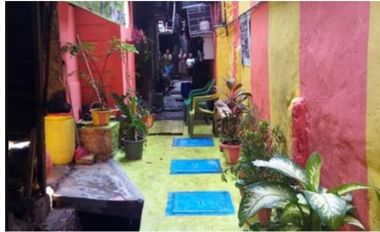
IPAL Komunal di lingkungan permukiman padat di RW 07 Kemayoran Jakarta
